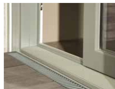
Er is een drempelverlaging tussen binnen en buiten. Afvoergoten in de kleur van het buitenschrijnwerk voeren het regenwater af.
